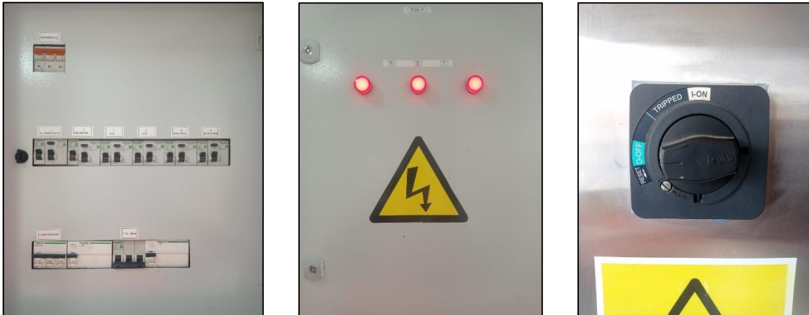
Ilustración 0.3: Interruptores de encendido
