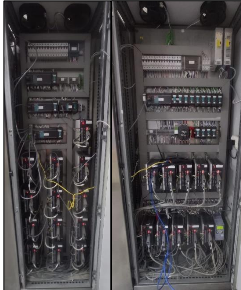
Ilustración 5.12: Gabinete de control electrónico.
