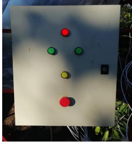
Fig. 4.37 Tablero en funcionamiento.
