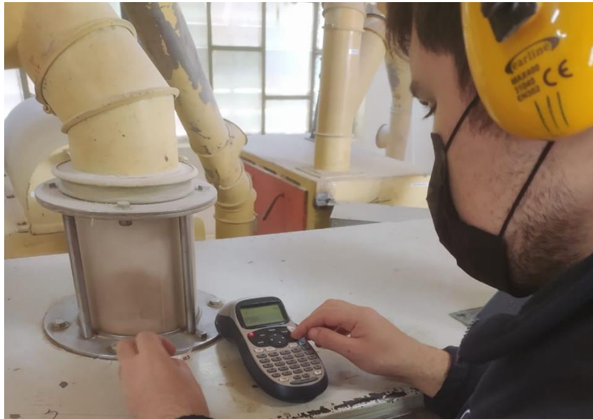
Ilustración 23: Estandarización de marcas de tuberías
