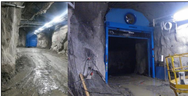
Figura 2.3 Compuerta para ventilación mineras subterránea (Nergeco, 2017).
