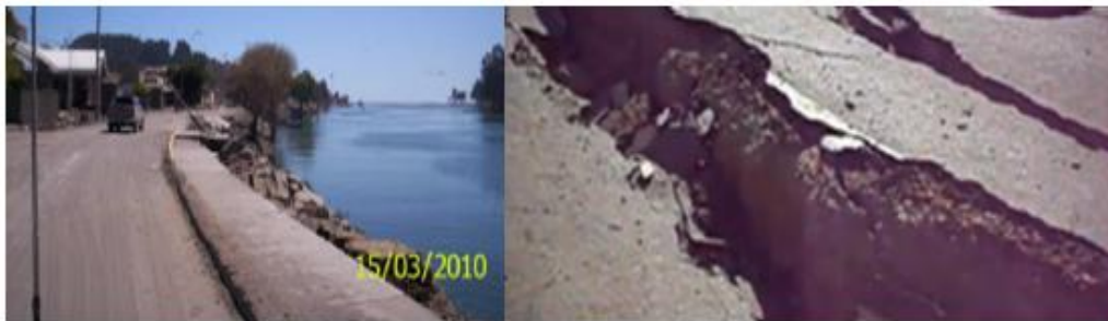
Ilustración 50: Daños provocados por el hundimiento del terreno a carreteras
