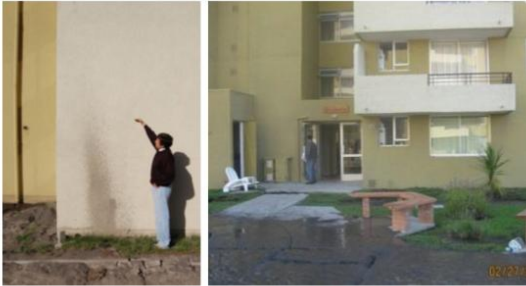
Ilustración 46: Asentamientos e inclinación de edificios.
