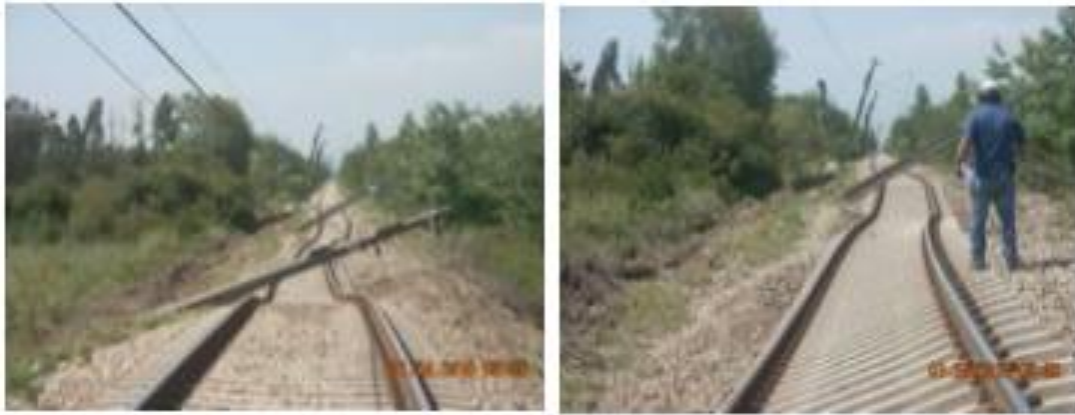
Ilustración 29: Hundimiento terraplén, inclinación de vías y caída de postes.
