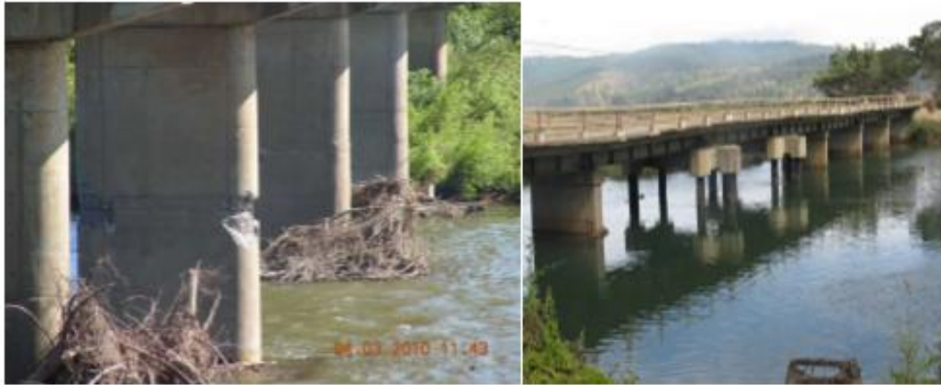
Ilustración 51: Daños provocados por el hundimiento del terreno a puentes.
