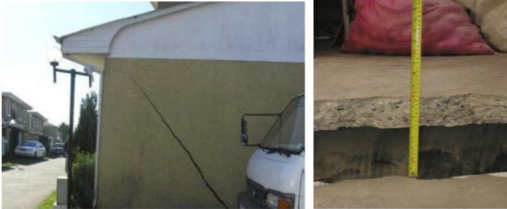
Ilustración 43: Grietas en muros y losas, debido a hundimientos y desplazamientos.
