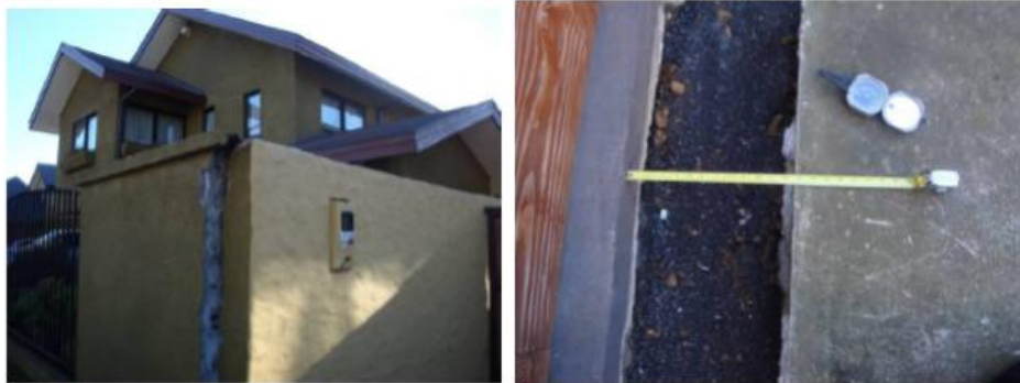
Ilustraci6n 40: Grietas y desplazamientos en viviendas.
