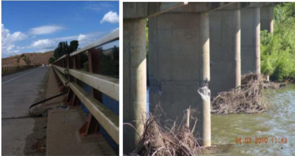
Ilustración 35: Daños evidentes en los pilares y tableros del puente.
