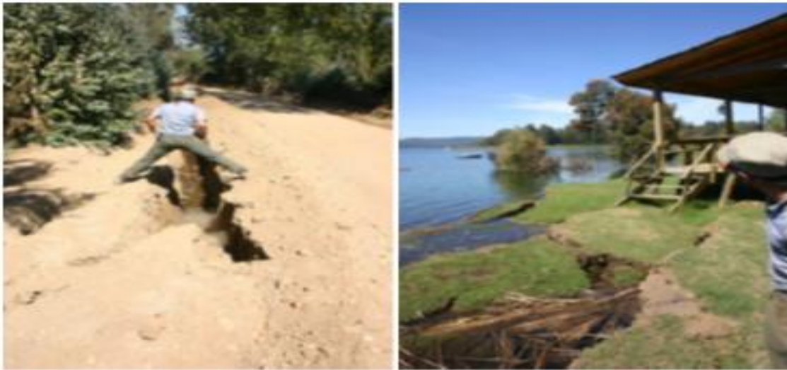
Ilustración 32: Desplazamientos y enormes grietas en el terreno.
