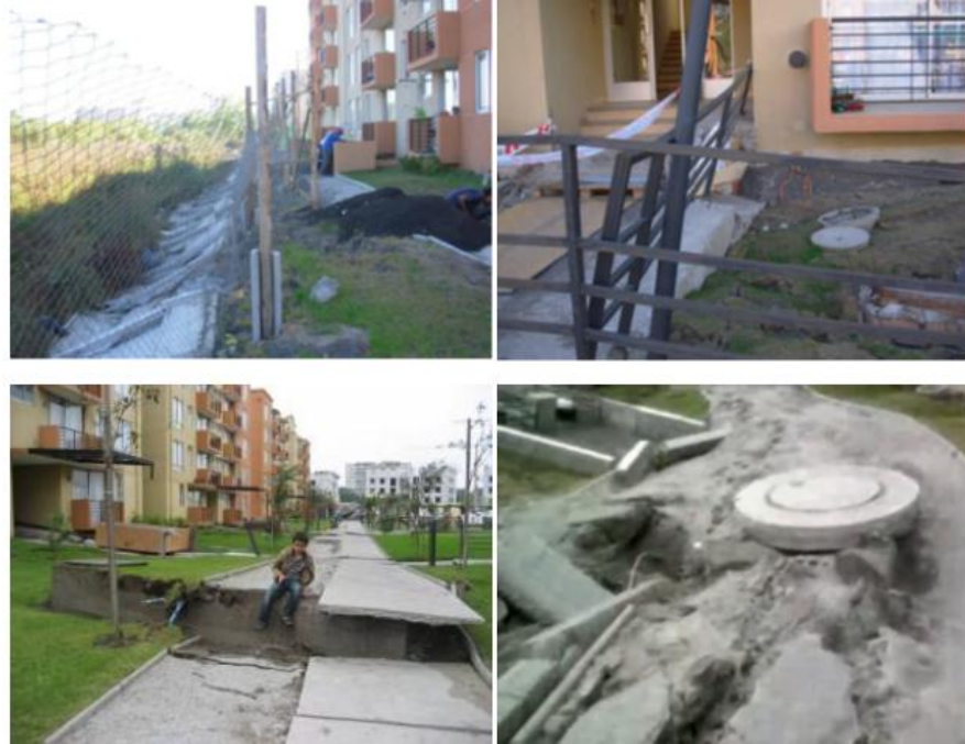
Ilustración 45: Asentamientos provocaron daños en los edificios y sistemas de alcantarillado.
