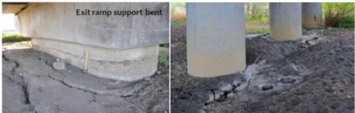
Ilustración 38: Grietas en el terreno y asentamientos de las columnas del puente.
