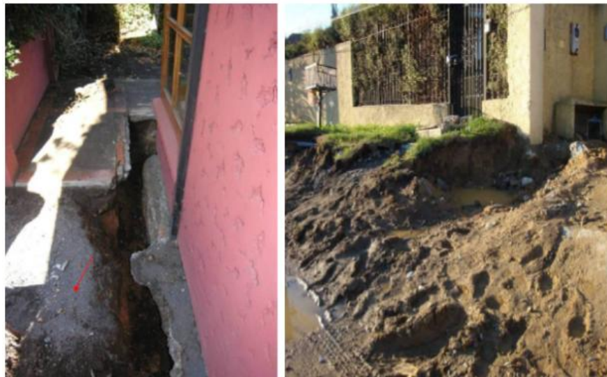
Ilustraci6n 41: Grietas y surgimiento de aguas subterr6neas.
