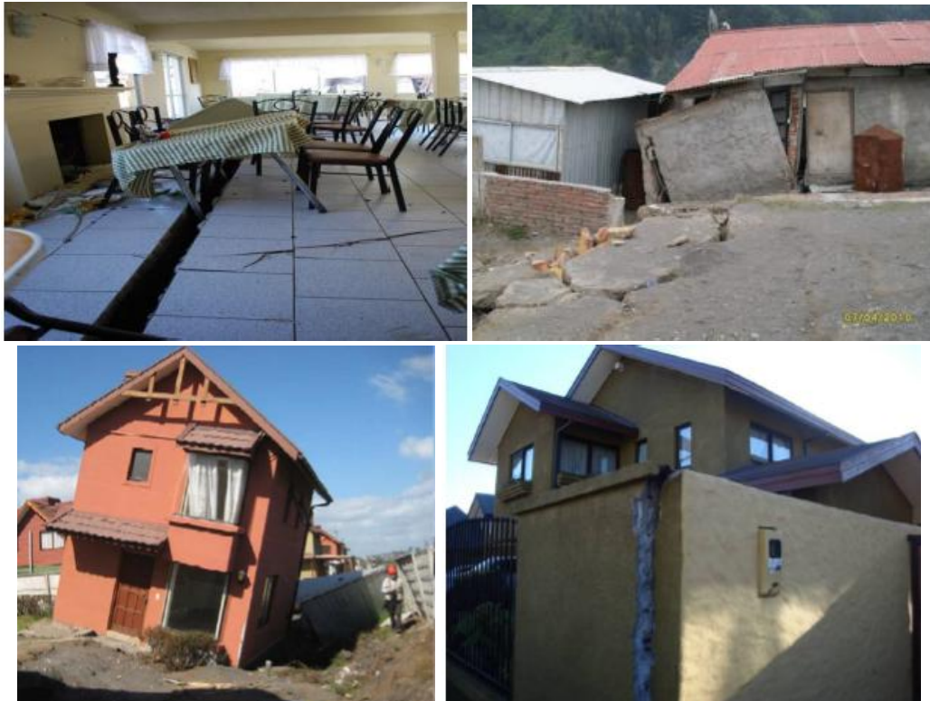
Ilustración 57: Daños provocados por el hundimiento del terreno a casas.
