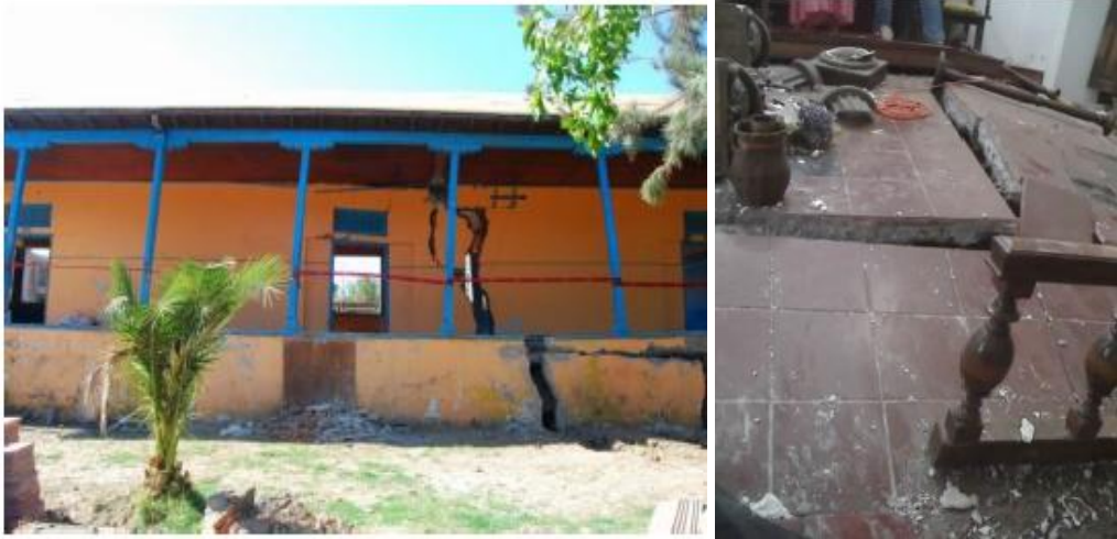
Ilustración 52: Daños provocados por el hundimiento del terreno a viviendas.
