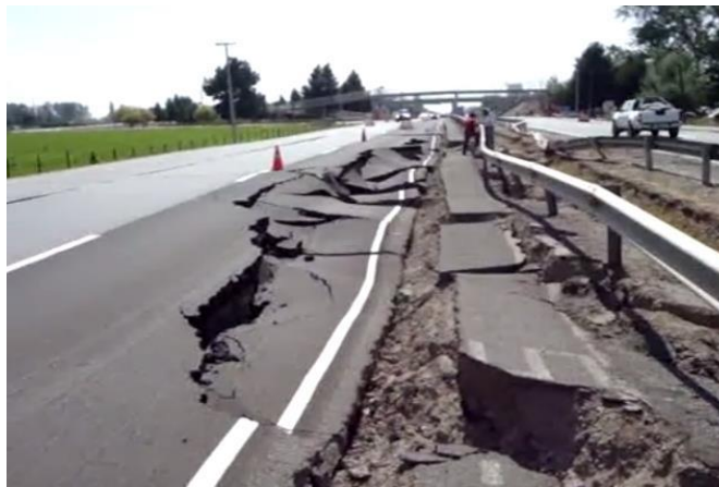
Ilustración 30: Daños en la calzada, caminos intransitables.
