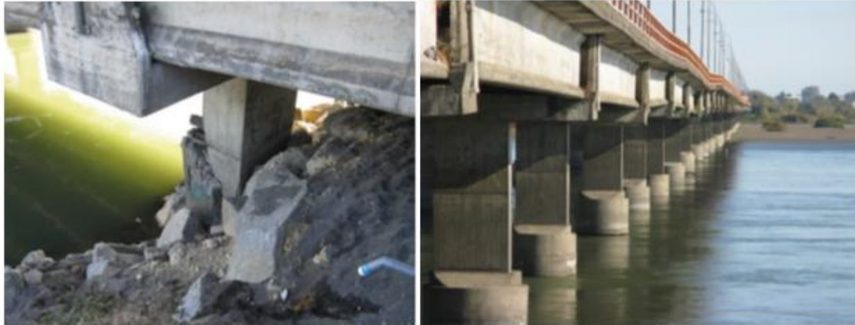
Ilustración 36: Daños y asentamientos en el estribo y pilares del puente.
