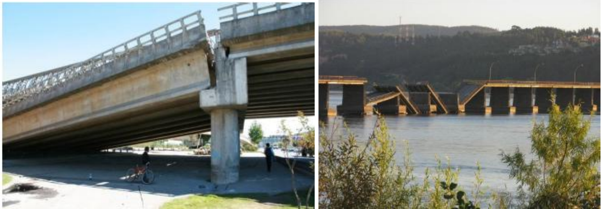
Ilustración 56: Daños provocados por el hundimiento del terreno a puentes.
