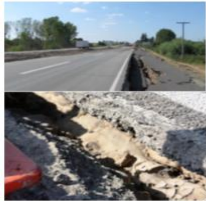
Ilustración 31: Grietas y desplazamientos en la carretera.
