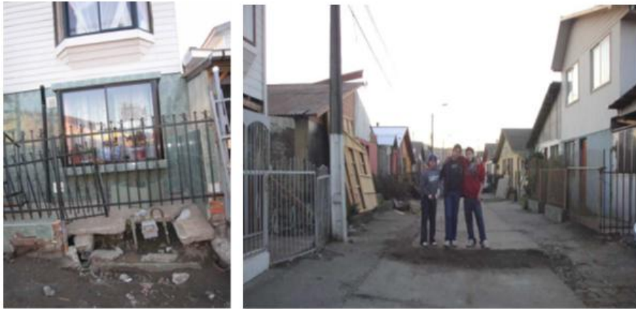
Ilustración 42: Asentamientos del terreno, rotura de matrices.
