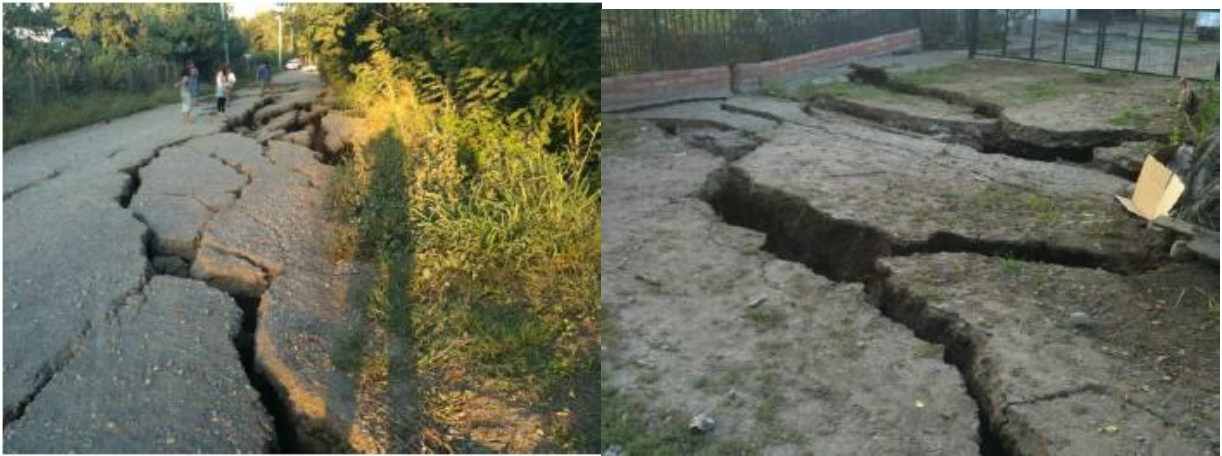
Ilustración 54: Daños provocados por el hundimiento del terreno a terrenos.
