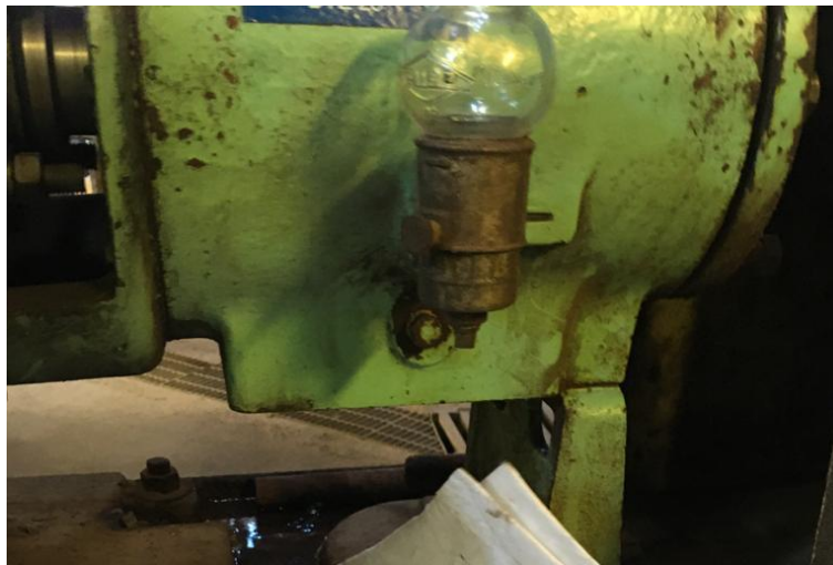
Figura 4-5: Nivel bajo de líquido lubricante en bomba, fuente propia
