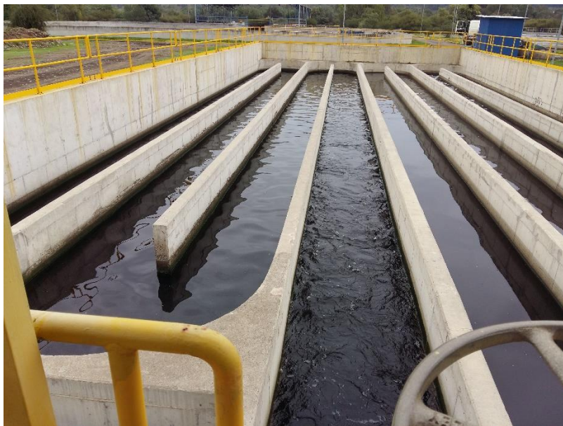
Ilustración 14: Estanque de contacto de cloración (Fuente: Elaboración propia)
