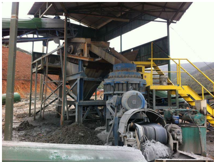
Fotografía 1: Planta de Chancado. Fuente: Reporte Técnico Proyecto Chépica
