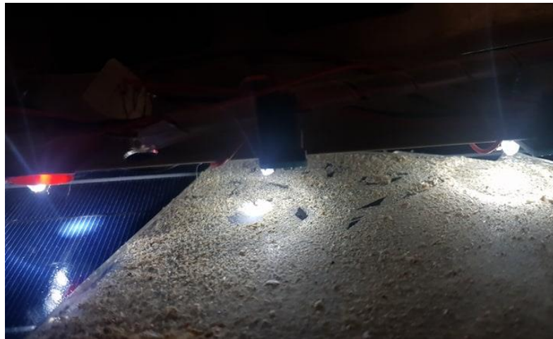
Fig.7.17: Escaneo sobre panel fotovoltaico variación de suciedad
