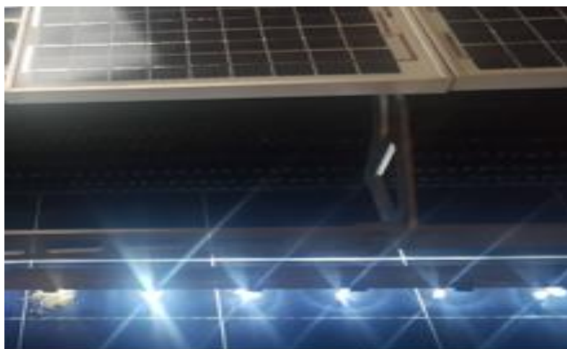
Fig.7.15: Escaneo sobre panel fotovoltaico con suciedad localizada
