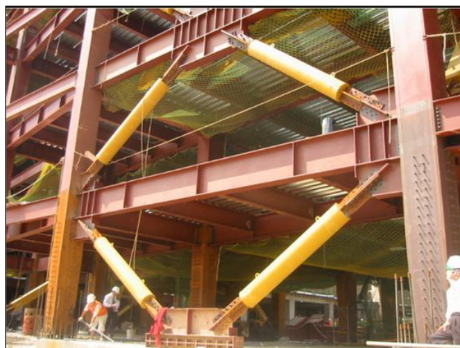
Imagen 27: Dissipador de energía extrusión de materiales tipo diagonales de pandeo rígido.
